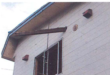
竜巻により壁に突き刺さった角材
