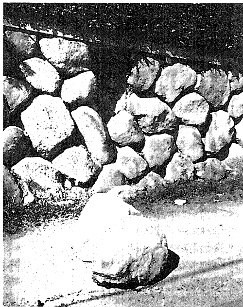
写真-2 空石積み擁壁の自然石の跳び出し(東灘区)
